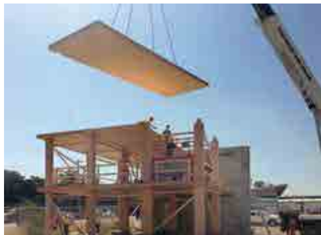
Premières étapes de la construction du bâtiment « Brock Commons » de 18 étages (CLT) © Acton Ostry Architects Inc. & University of British Columbia.
